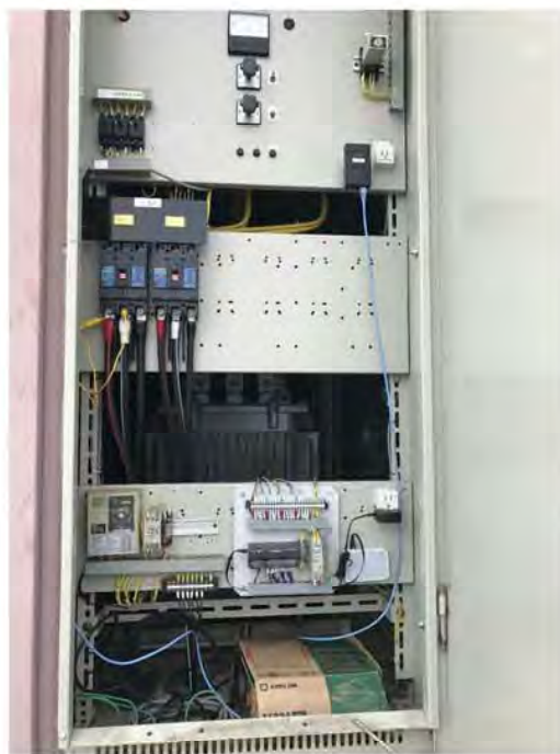
屋上キュービクル内部
